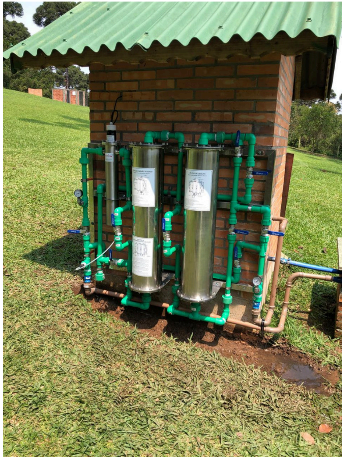
Água de Poço
